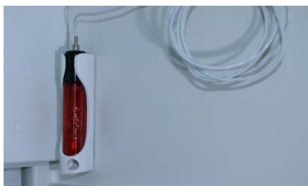
Abbildung 11: An Seitenwand angebrachter Fühler mit Glykol-Ampulle
